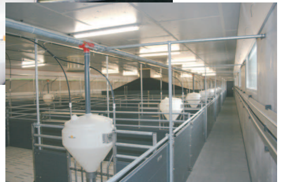
Stalleinrichtung mit Rohrautomaten
