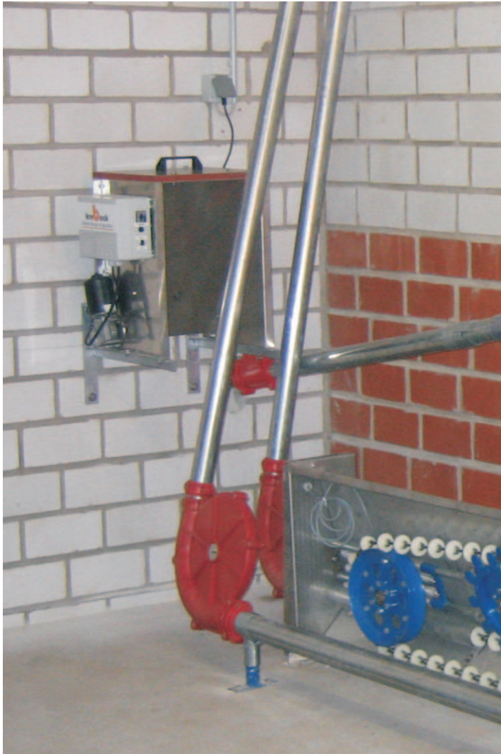
Trockenfütterungsanlage mit Medidosierer
