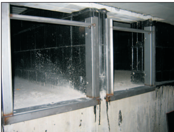
Güleschieber im Kanal an der Mittelwand
